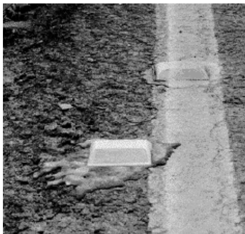
Figura 12. Demarcación mediante captaluces
