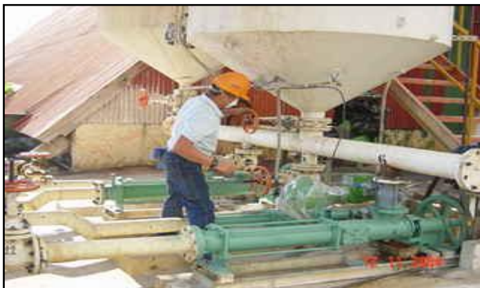
Figura 17. Bomba de desplazamiento positivo instalada en estación de sacarato
