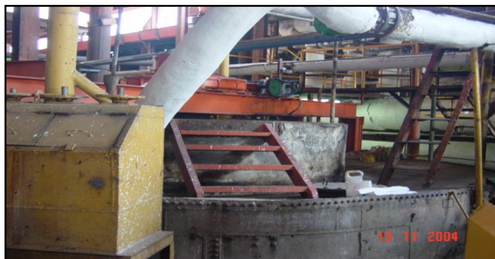
Figura 12. Clarificador de jugo
