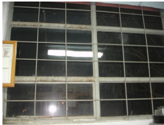
Figura 15. Condiciones actuales de ventilación, edificio T-7
