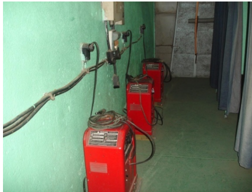
Figura 16. Máquinas de soldadura eléctrica, edificio T-7
