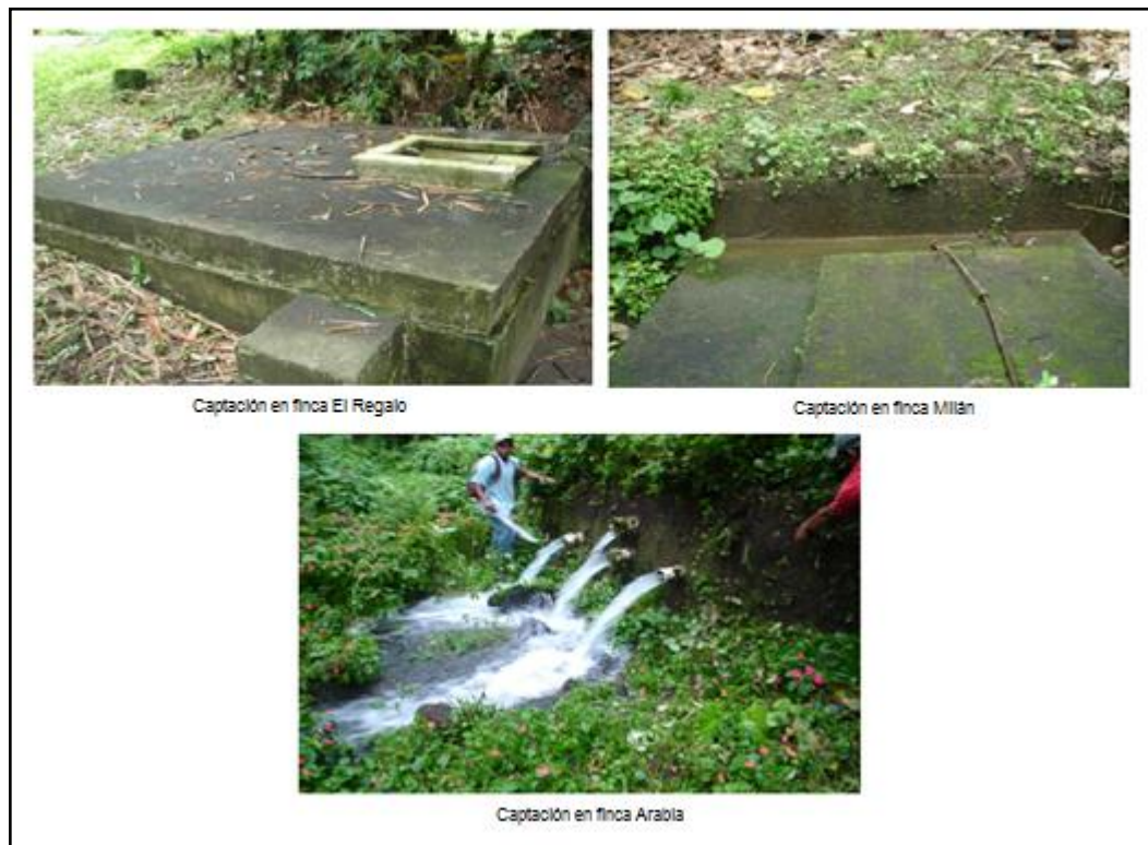
Figura 7. Tanques de captación del sistema
