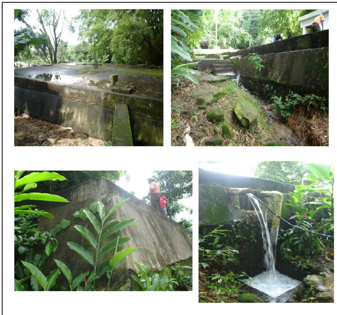
Figura 11. Tanque de distribución
