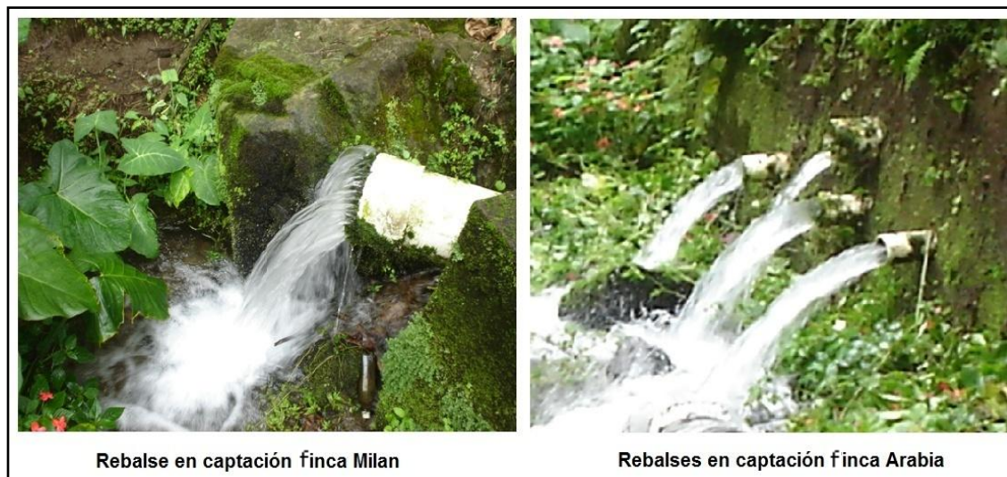
Figura 8. Tubería de rebalse en las captaciones
