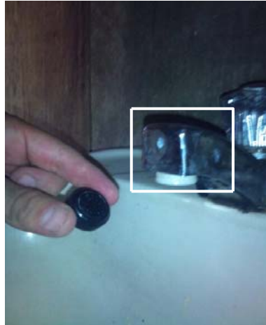
Figura 20. Lavamanos sin aireador
