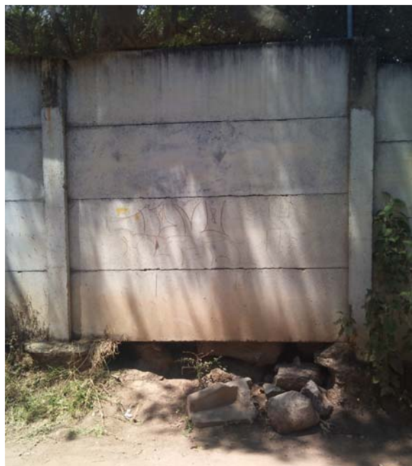
Figura 34. Cimientos de muros en Strike Zone
