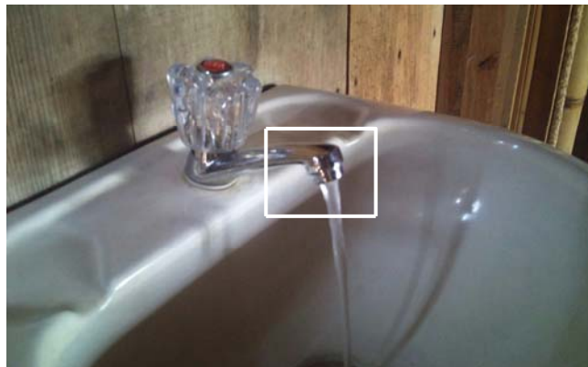
Figura 23. Lavamanos con aireador
