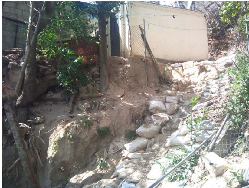
Figura 37. Cimiento de vivienda socavado
