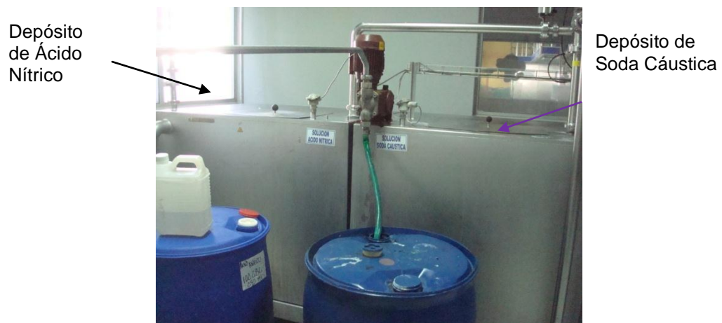
Figura A. Depósitos de soda cáustica y ácido nítrico del Alcip
