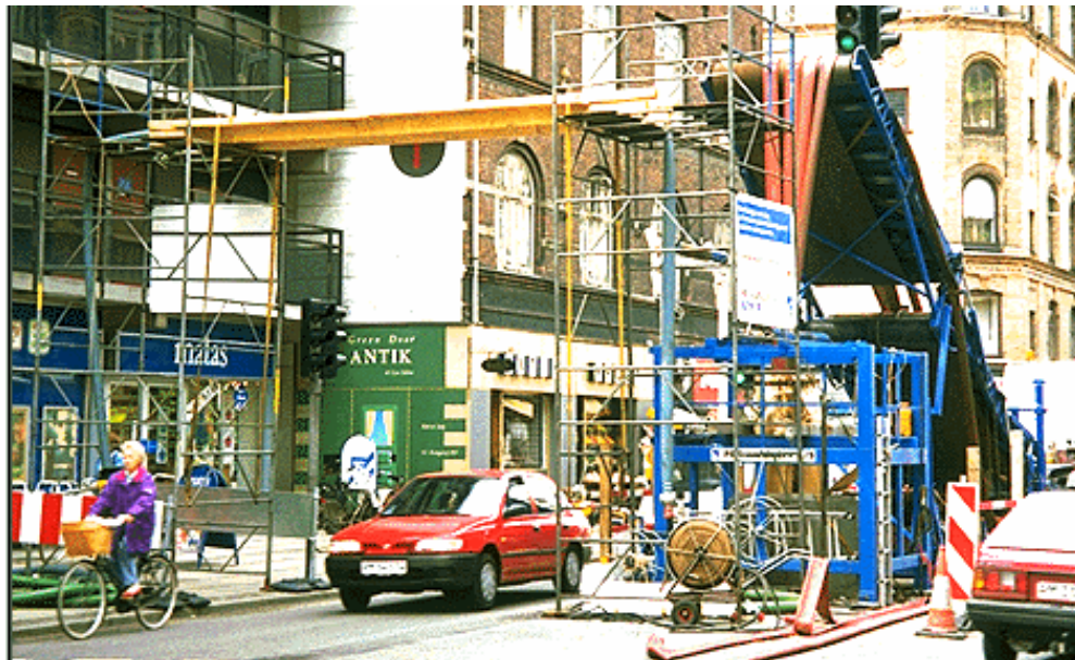
Figura 18. Torre de inversión
