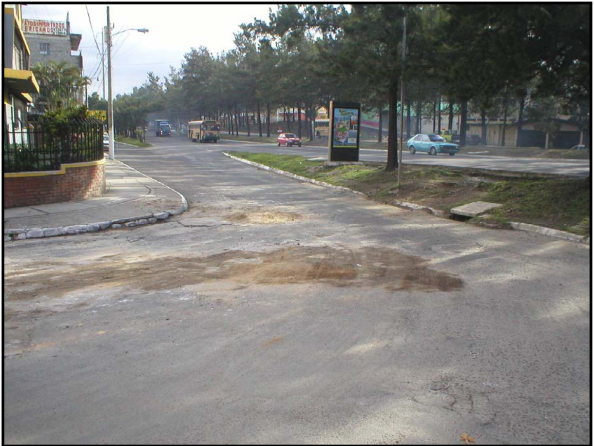
Figura 39. Relleno, sin carpeta asfáltica
