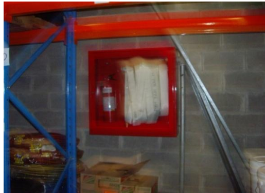
Figura 27. Ubicación de extintores
