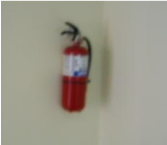
Figura 29. Extintores no identificados
