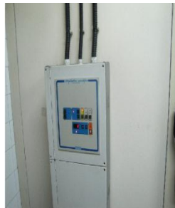
Figura 72. Control de temperatura de refrigerador
