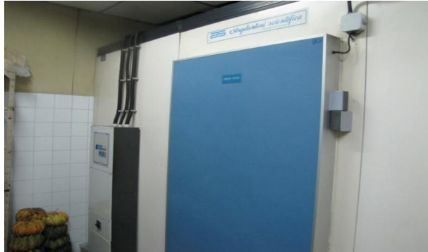
Figura 25. Refrigerador para almacenar productos perecederos
