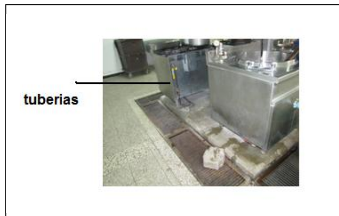
Figura 79. Tubería de la estufa
