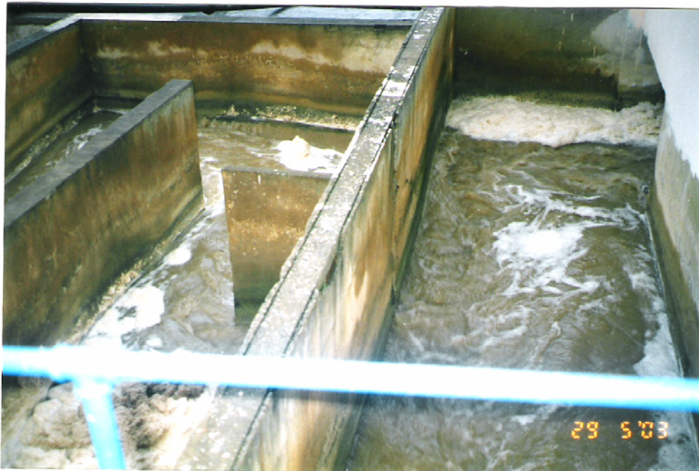
Figura 5 Sistema de floculación
