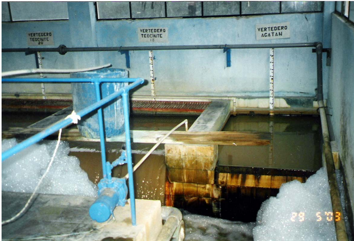
Figura 2 Vertederos de ingreso a la planta
