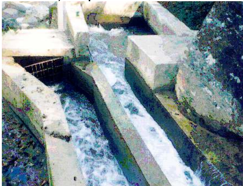
Figura 13. Canal de alivio, más canal de captación del sistema de abastecimiento de agua potable del municipio de Gualán, Zacapa
