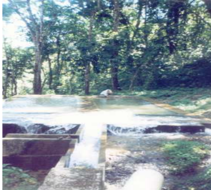
Figura 14. Desarenador del sistema del abastecimiento de agua potable del municipio de Gualán, Zacapa
