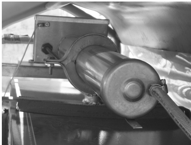
Figura 12. Generador de ozono
