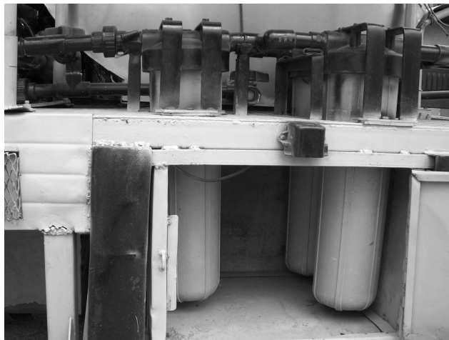
Figura 10. Filtros de carbón activado
