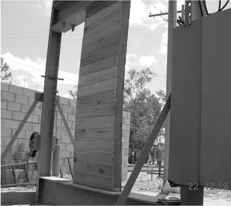
Figura 37. Falla por pandeo carga máxima 37,000 libras
