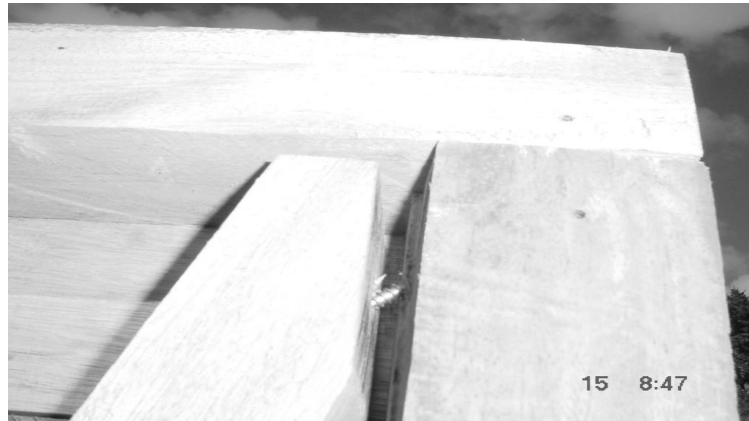
Figura 48. Falla tornillo a tensión, en esquina del ladeo
