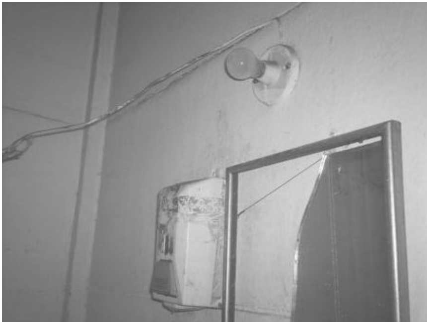
Figura 37. Sanitario en mal estado
