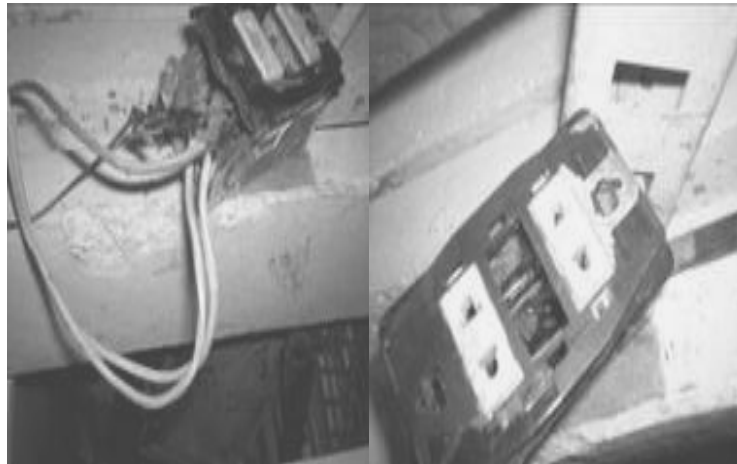
Figura 38. Instalaciones eléctricas en mal estado
