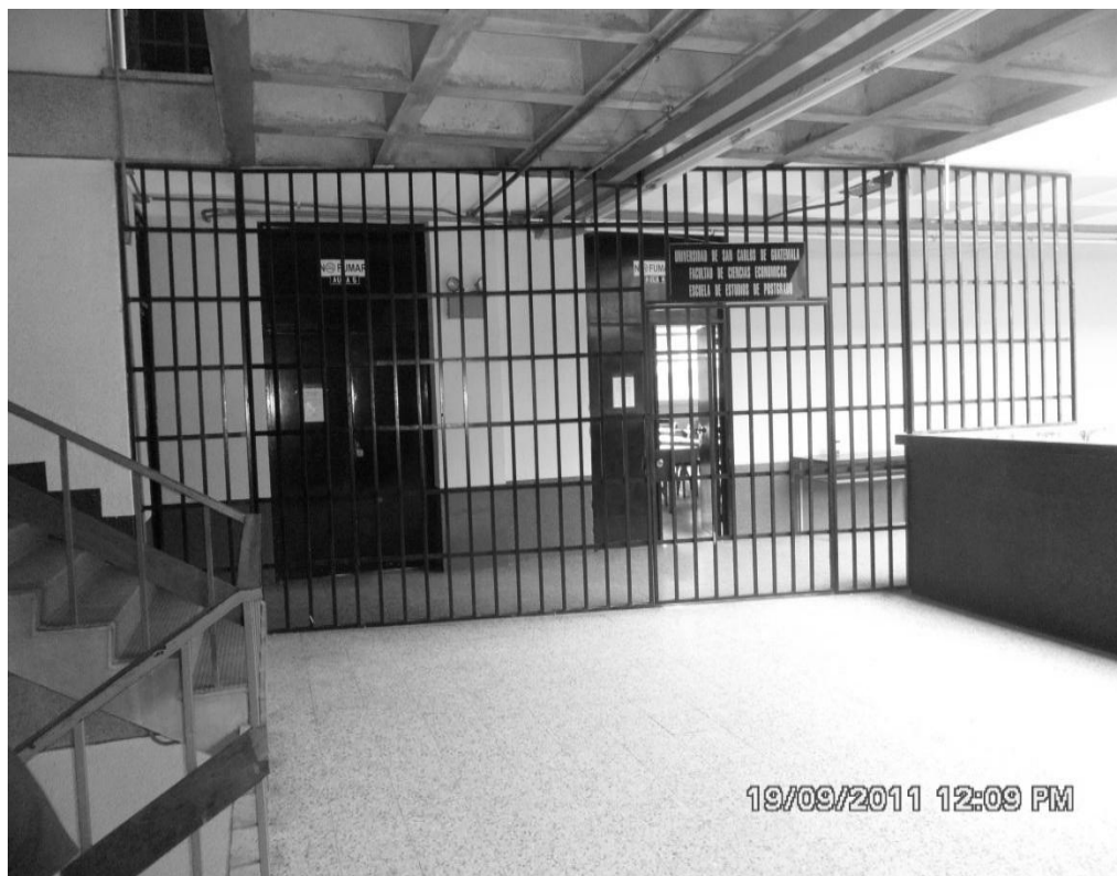
Figura 21. Segundo nivel postgrado de económicas, rejas cerradas que abren hacia el interior
