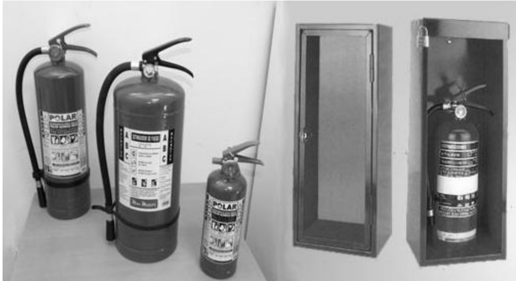
Figura 25. Extinguidores para combatir incendios en bodegas y oficinas
