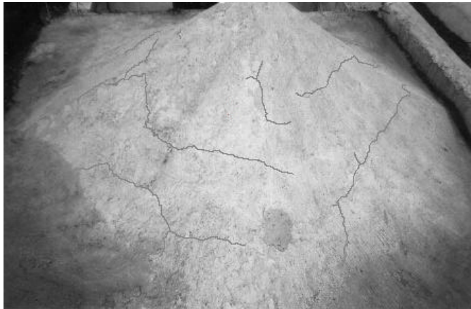
Figura 36 Ubicación de fisuras en el paraboloides hiperbólico
