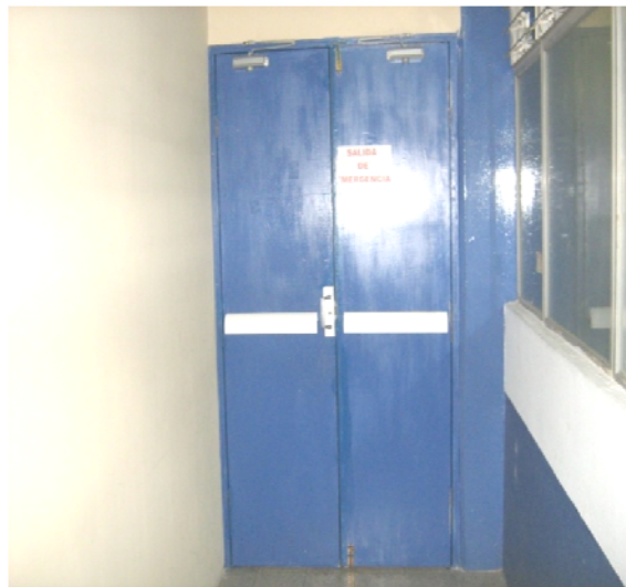
Figura 79. Salida de emergencia
