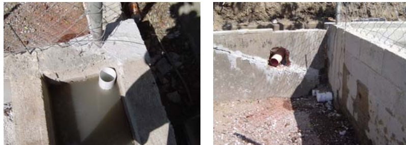
Figura XXX. Tubería para regular el caudal en la caja de entrada y tubería para facilitar la limpieza en la caja de entrada.
