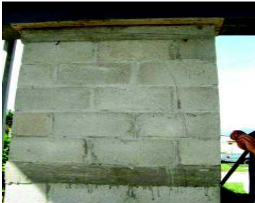
Falla en Muro a Compresión
