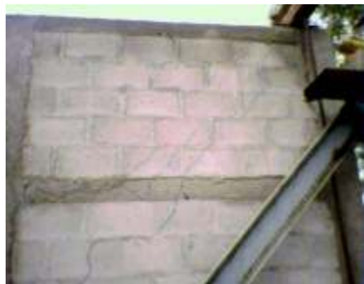
Falla en muro a Corte
