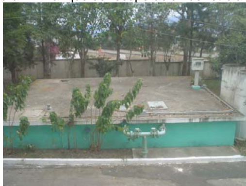
Figura 21. Tanque de recuperación de retrolavado
