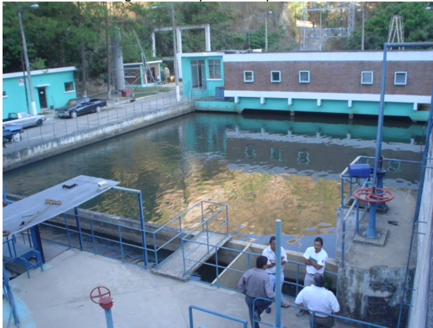
Figura 7. Tanque de compensación
