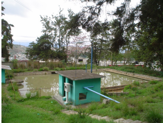
Figura 20. Tanque de recuperación de lodos
