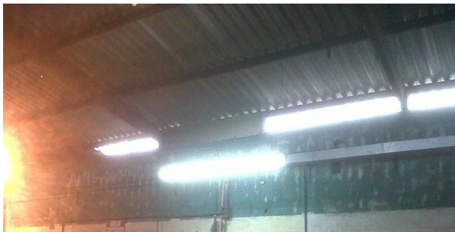
Figura 43. Salidas de aire en planta
