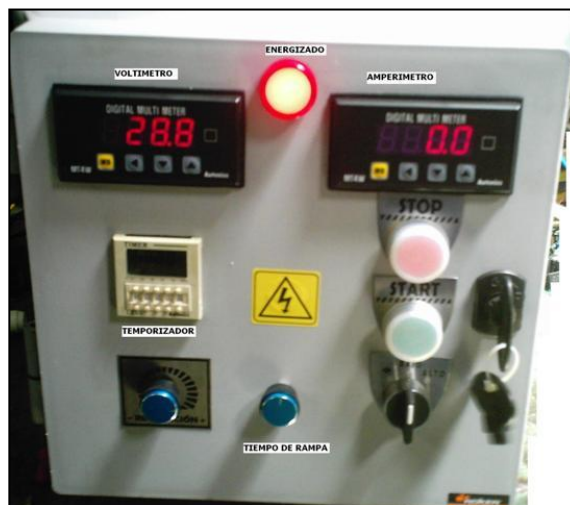
Figura 10. Parte frontal del rectificador de corriente
