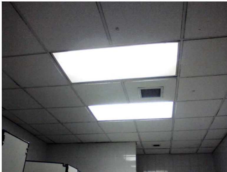
Figura 26. Luminarias del Restaurante Escuela
