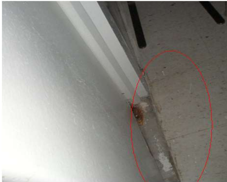
Figura 17. Desnivel de piso
