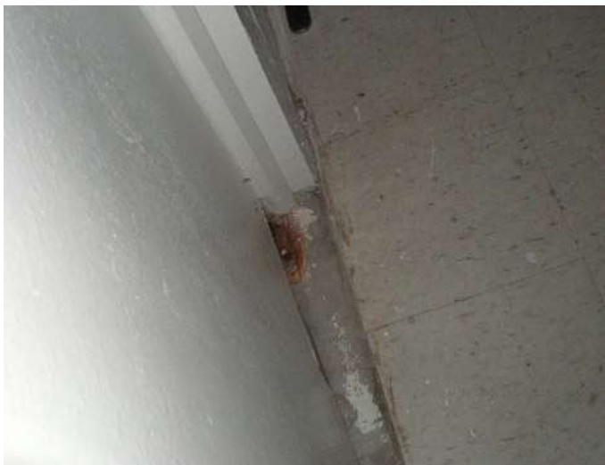
Figura 7. Desnivel de piso
