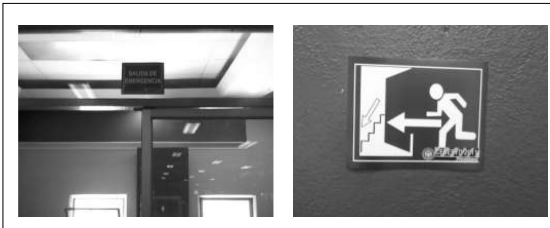
Figura 43. Señalización rutas de emergencia RE
