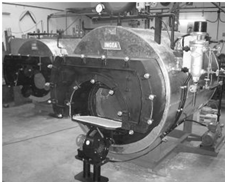
Figura 4. Imagen de caldera
