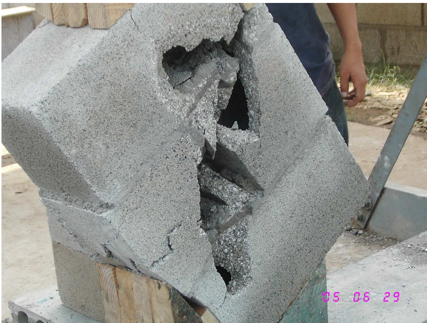
Figura No. 7 Falla prisma a corte
