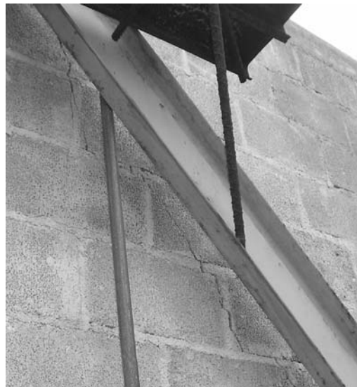
Figura 30. Falla muro a corte
