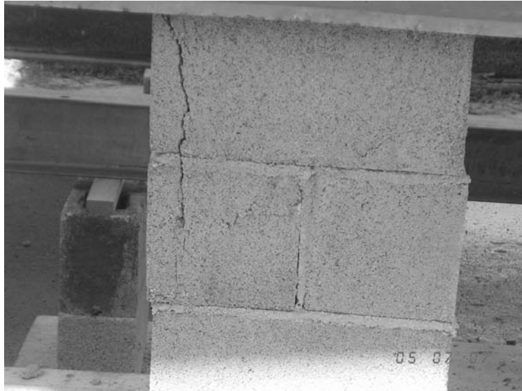
Figura 11. Falla típica ensayo a compresión prismas
