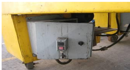
Figura 17. Caja de control
