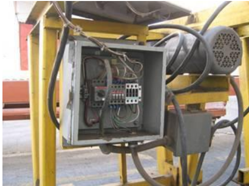
Figura 19. Caja de control y sus accesorios
