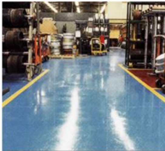
Figura 16. No hay daño en la pintura. Piso bodega almacenamiento de materia prima, empresa procesadora de alimentos
