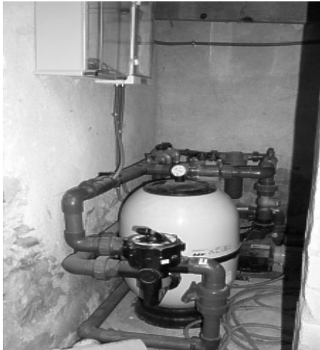
Figura 22 . Sistema de filtración por arenas.
