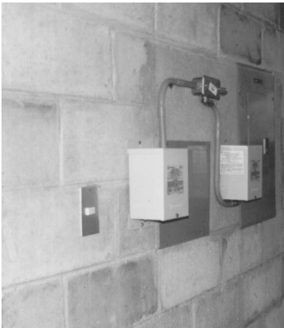
Figura 33. Transformadores de voltaje para lámparas.
