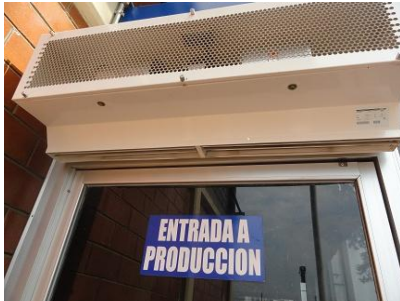
Figura 34. Sistema de aire en entrada a planta para generar presión positiva
