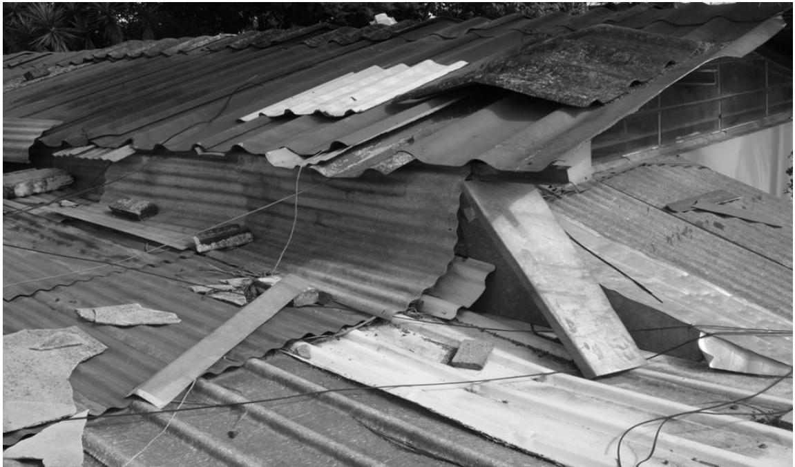
Figura 6. Estado actual de los techos
