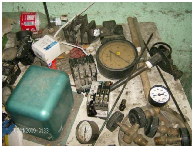
Figura 17. Área de calderas
