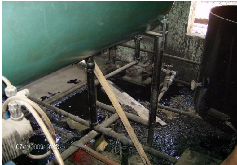
Figura 7. Área de calderas
