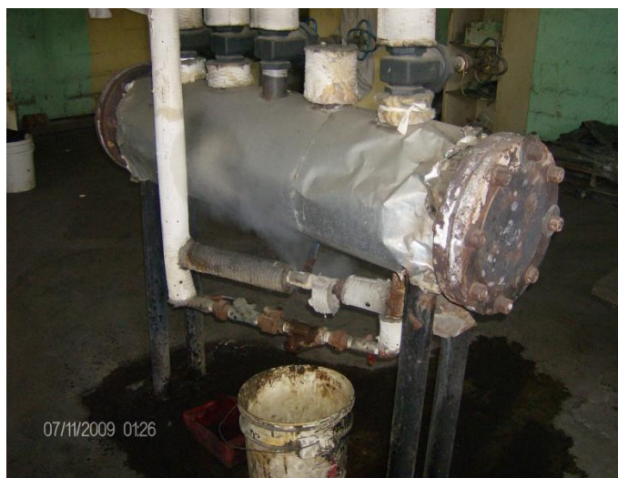
Figura 9. Área de calderas
