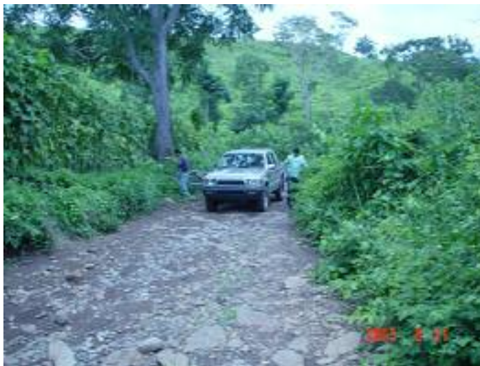
Figura 1. Fotografía del tramo superficie rocosa, (35%) mal estado.
