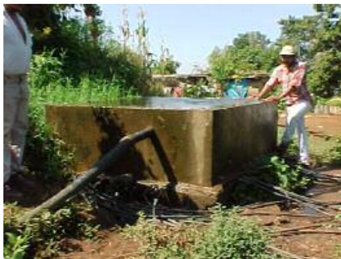
Figura 5. Fotografía de caja de distribución, carente de protección (Nueva Bendición).
