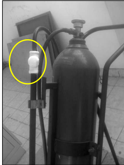
Figura 8. Fuga de CO 2 por la manguera
