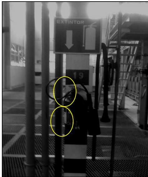
Figura 7. Extintor en mal estado
