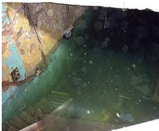
Figura 7. Sótano del Hospital Roosevelt inundado
