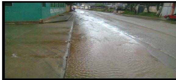
Figura 50. Falta de drenajes públicos
