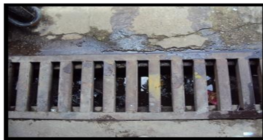
Figura 51. Drenajes de la empresa sin mantenimiento
