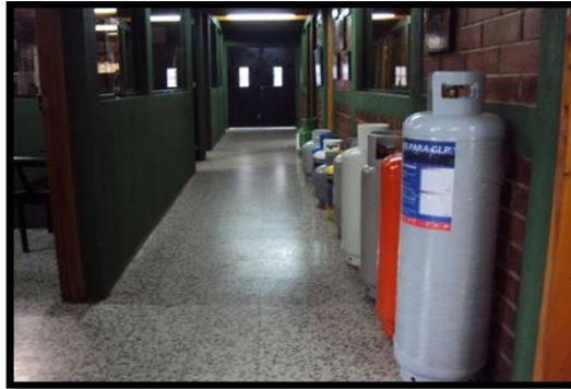
Figura 54. Cilindros obstaculizan pasillo central de oficinas
