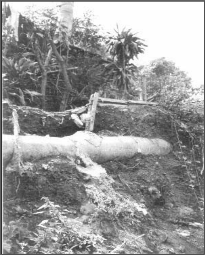
Figura 11. La siguiente imagen muestra como los drenajes se han ido erosionando
