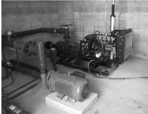
Figura 45. Cuarto de máquinas sistema contra incendios
