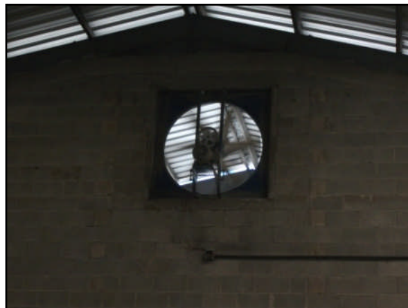
Figura 25. Ventilación de la empresa BETANTÉCNICA, S.A.
