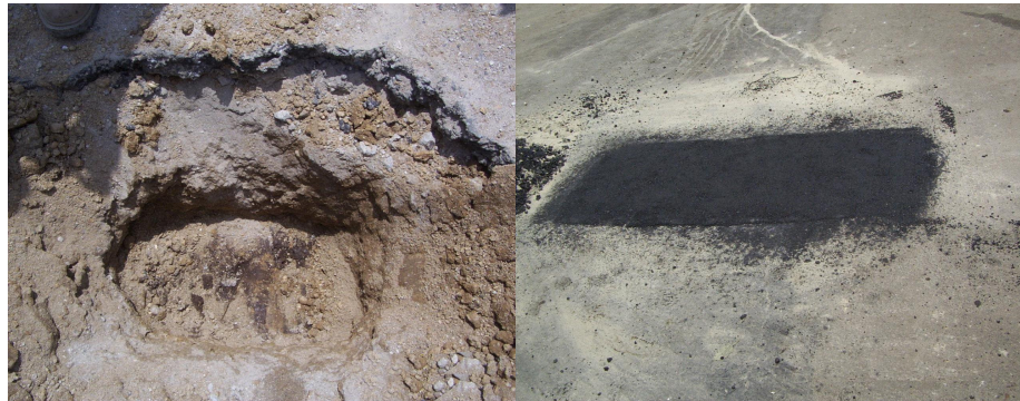
Figura 16. Ejemplo de un pozo a cielo abierto terminado y posteriormente impermeabilizado mediante un bacheo menor.
