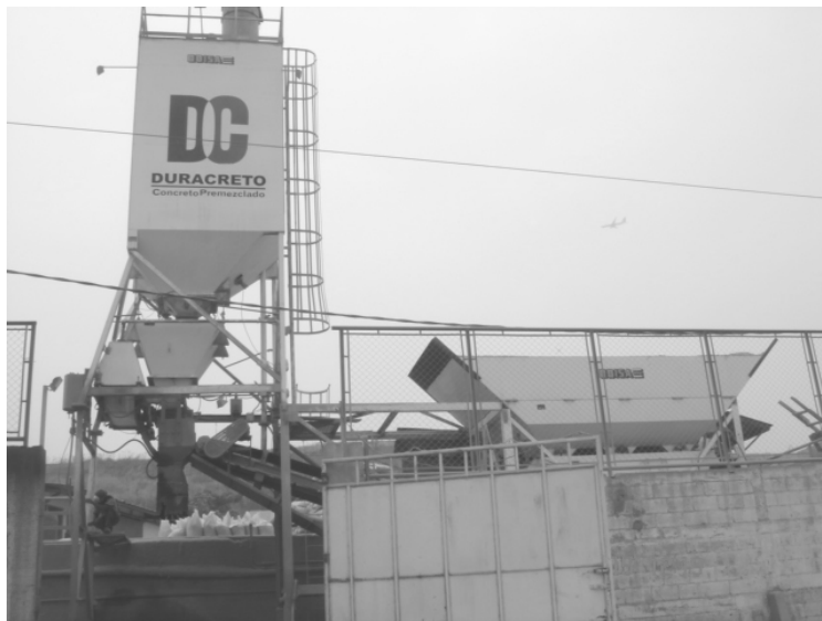
Figura 9. Planta de dosificación
