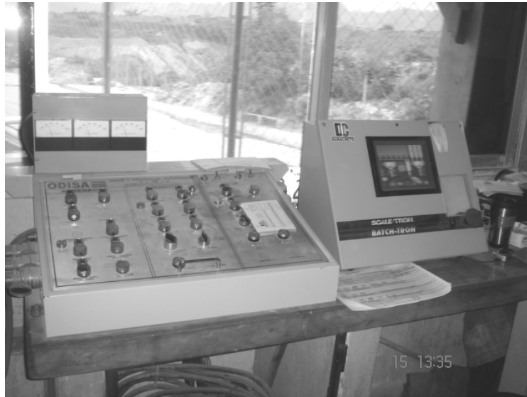
Figura 12. Tablero de control planta de dosificación
