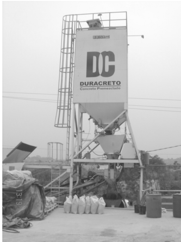
Figura 10. Silo para almacenamiento del cemento
