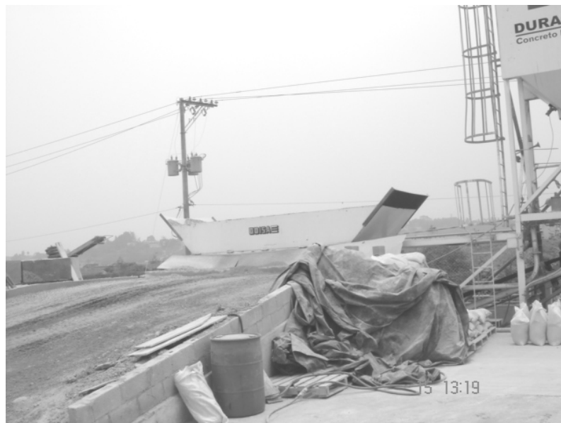
Figura 11. Tolvas para agregados
