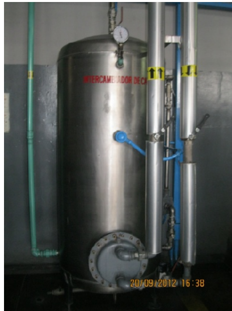
Figura 5. Depósito de agua
