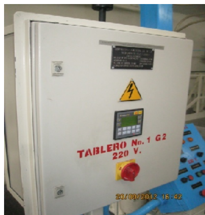
Figura 9. PLC para control de flujo de harina
