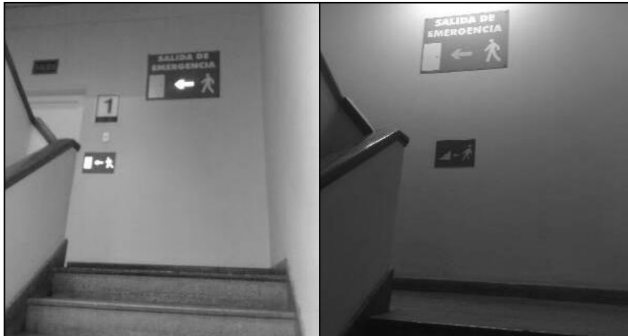
Figura 22. Señalización rutas de evacuación
