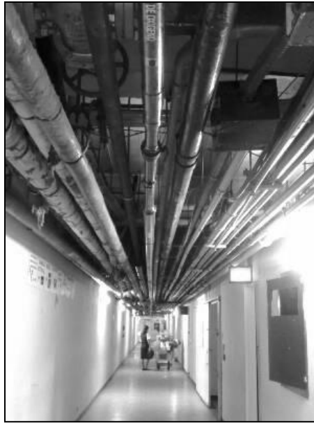
Figura 15. Tuberías red de gases médicos
