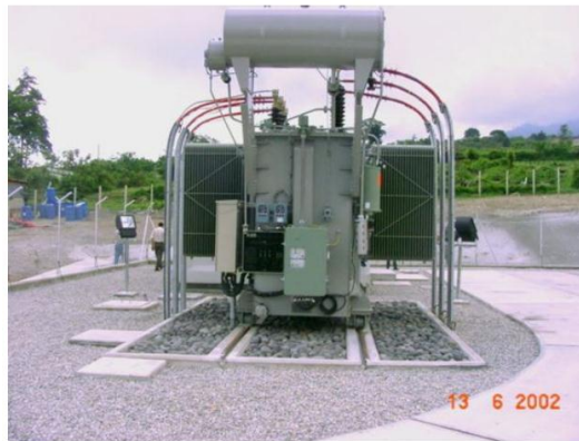
Figura 27. Transformador en uso
