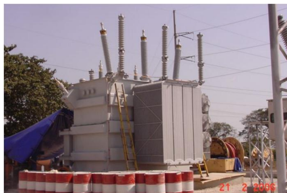
Figura 29. Organización de transformadores en desuso previo al reciclaje
