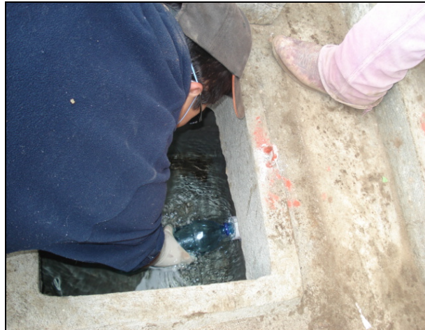
Figura 22. Técnico tomando una muestra de agua en una caja de captación
