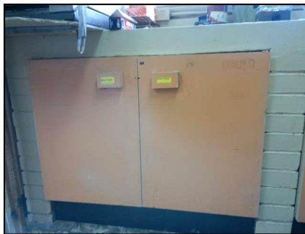
Figura 50. Gabinetes previo a la señalización en el Laboratorio de Monitoreo del Aire
