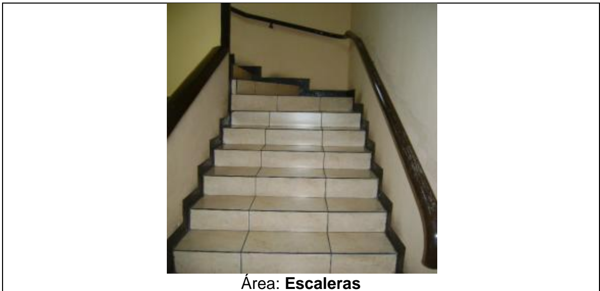
Figura 66. Peligro de deslizamiento
