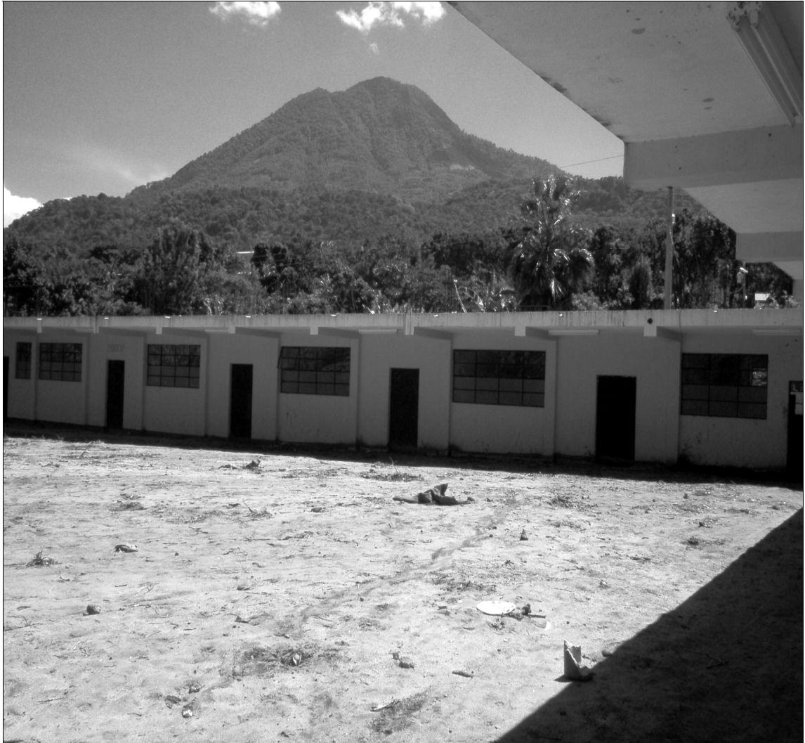
Figura 59. Daños en la escuela, Vista al Este.
