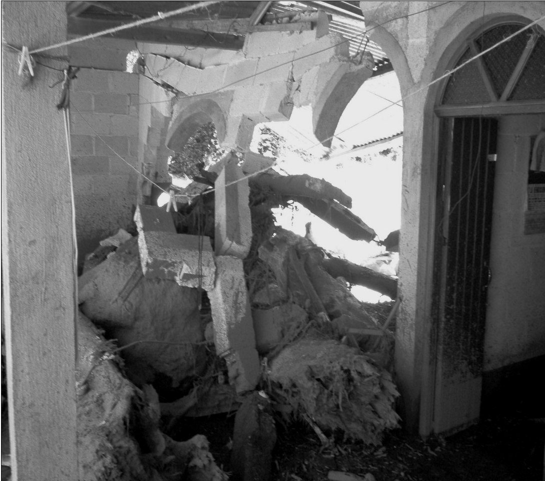
Figura 58. Vista interior de la vivienda afectada en la figura anterior.
