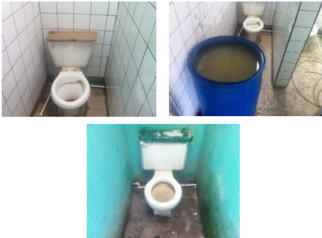
Figura 14. Auditoria de riesgo falta de higiene
